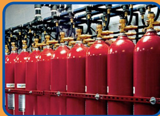
Sistemas de Extinción de Incendios
